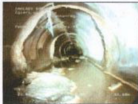
Nr sekcji: 10, Zdjęcie: 97a, Nr taśmy: , 00:00:00, Pęknięcie wzdłużne, z 11 do 12
