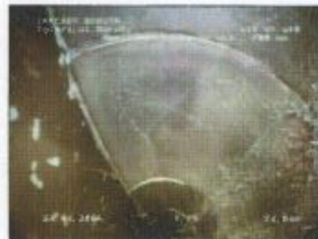
Nr sekcji: 12, Zdjęcie: 125a, Nr taśmy: , 00:00:00, Pęknięcie wzdłużne, o 09
