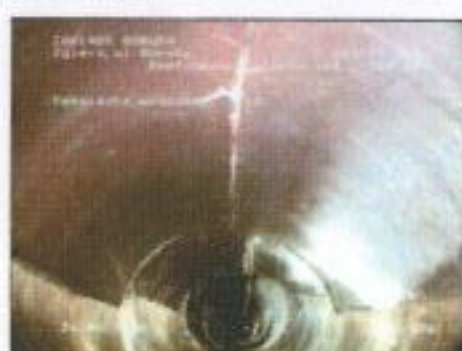
Nr sekcji: 10, Zdjęcie: 82a, Nr taśmy: , 00:00:00, Pęknięcie wzdłużne, o 12
