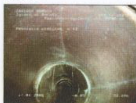
Nr sekcji: 11, Zdjęcie: 111a, Nr taśmy: , 00:00:00, Pęknięcie wzdłużne, o 12
