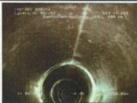
Nr sekcji: 9, Zdjęcie: 65a, Nr taśmy: , 00:00:00, Pęknięcie wzdłużne, o 01
