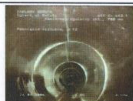
Nr sekcji: 11, Zdjęcie: 104a, Nr taśmy: , 00:00:00, Pęknięcie wzdłużne, o 12
