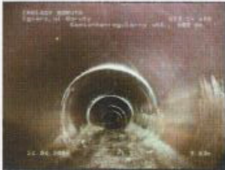
Nr sekcji: 8, Zdjęcie: 51a, Nr taśmy: , 00:00:00, Pęknięcia wzdłużne, z 11 do 01
