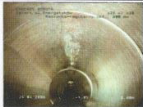
Nr sekcji: 3, Zdjęcie: 16a, Nr taśmy: , 00:00:00, Pęknięcie wzdłużne, o 12
