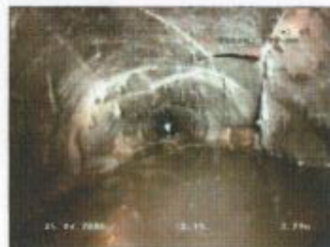
Nr sekcji: 16, Zdjęcie: 140a, Nr taśmy: , 00:00:00, Wiele pęknięć, z 09 do 03
