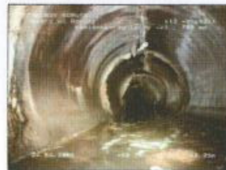
Nr sekcji: 10, Zdjęcie: 98b, Nr taśmy: , 00:00:00, Pęknięcie wzdłużne, o 12
