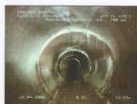
Nr sekcji: 11, Zdjęcie: 112a, Nr taśmy: , 00:00:00, Pęknięcie wzdłużne, o 01
