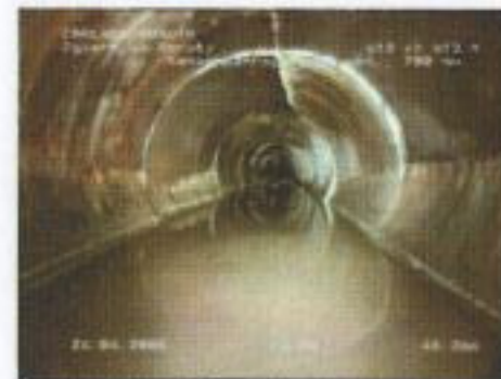
Nr sekcji: 10, Zdjęcie: 95a, Nr taśmy: , 00:00:00, Wiele pęknięć, z 09 do 03
