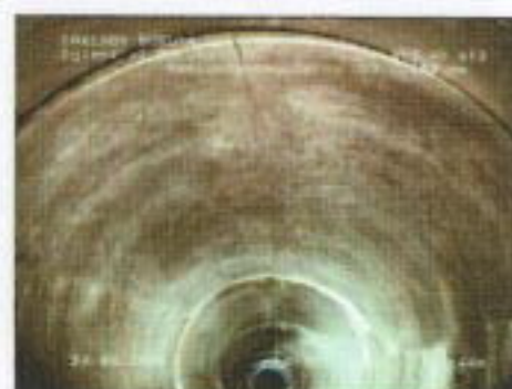
Nr sekcji: 9, Zdjęcie: 71a, Nr taśmy: , 00:00:00, Pęknięcie wzdłużne, o 12
