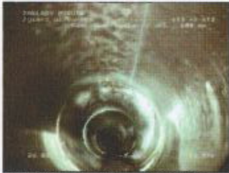
Nr sekcji: 9, Zdjęcie: 57a, Nr taśmy: , 00:00:00, Wiele pęknięć, z 09 do 03
