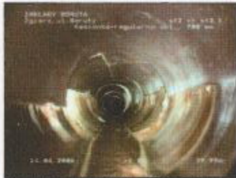
Nr sekcji: 10, Zdjęcie: 91a, Nr taśmy: , 00:00:00, Wiele pęknięć, z 08 do 04
