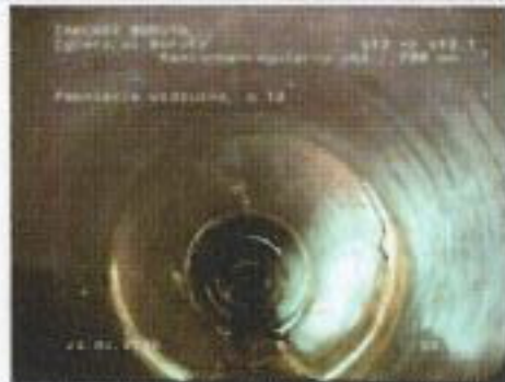
Nr sekcji: 10, Zdjęcie: 85a, Nr taśmy: , 00:00:00, Pęknięcie wzdłużne, o 12
