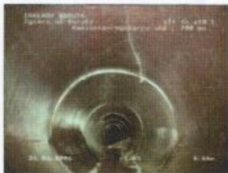
Nr sekcji: 11, Zdjęcie: 105a, Nr taśmy: , 00:00:00, Pęknięcie wzdłużne, o 12
