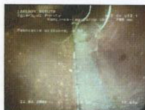
Nr sekcji: 11, Zdjęcie: 107a, Nr taśmy: , 00:00:00, Pęknięcie wzdłużne, o 04
