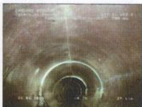
Nr sekcji: 11, Zdjęcie: 110a, Nr taśmy: , 00:00:00, Pęknięcie wzdłużne, o 12
