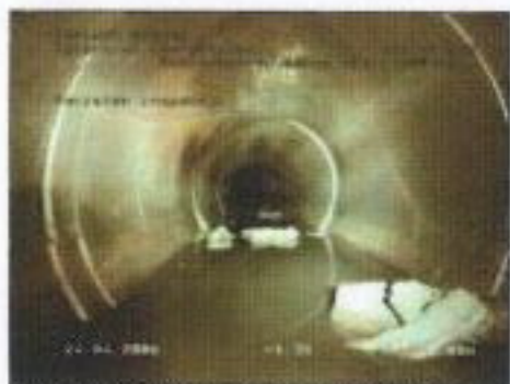
Nr sekcji: 3, Zdjęcie: 12a, Nr taśmy: , 00:00:00, Wiele pęknięć, z 08 do 04
