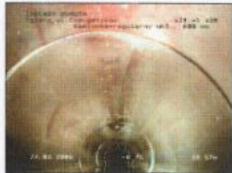
Nr sekcji: 3, Zdjęcie: 19a, Nr taśmy: , 00:00:00, Pęknięcie wzdłużne, o 01
