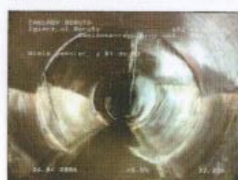
Nr sekcji: 10, Zdjęcie: 83a, Nr taśmy: , 00:00:00, Wiele pęknięć, z 09 do 03
