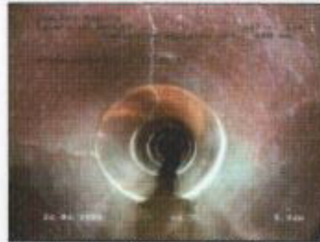
Nr sekcji: 7, Zdjęcie: 47b, Nr taśmy: , 00:00:00, Wiele pęknięć, z 12 do 12
