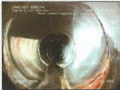
Nr sekcji: 10, Zdjęcie: 84a, Nr taśmy: , 00:00:00, Wiele pęknięć, z 09 do 01
