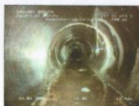
Nr sekcji: 11, Zdjęcie: 116a, Nr taśmy: , 00:00:00, Pęknięcie wzdłużne, o 01
