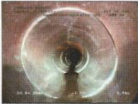
Nr sekcji: 7, Zdjęcie: 47a, Nr taśmy: , 00:00:00, Wiele pęknięć, z 12 do 12
