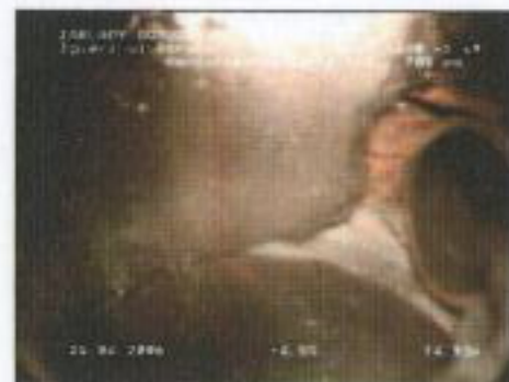
Nr sekcji: 13, Zdjęcie: 129a, Nr taśmy: , 00:00:00, Odgałęzienie, o 03
