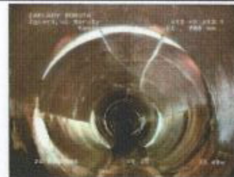
Nr sekcji: 10, Zdjęcie: 87a, Nr taśmy: , 00:00:00, Wiele pęknięć, z 09 do 03
