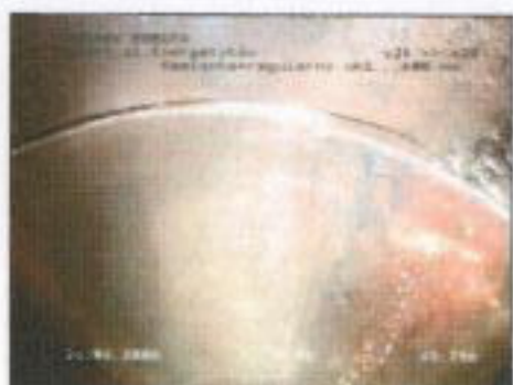
Nr sekcji: 3, Zdjęcie: 26a, Nr taśmy: , 00:00:00, Pęknięcie wzdłużne, o 11
