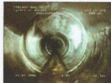
Nr sekcji: 9, Zdjęcie: 59a, Nr taśmy: , 00:00:00, Wiele pęknięć, z 09 do 03
