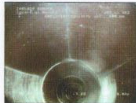
Nr sekcji: 9, Zdjęcie: 55a, Nr taśmy: , 00:00:00, Wiele pęknięć, z 10 do 02
