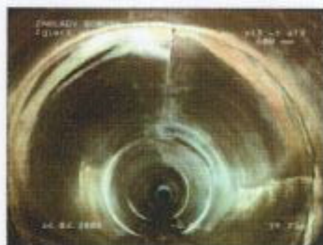
Nr sekcji: 9, Zdjęcie: 70a, Nr taśmy: , 00:00:00, Wiele pęknięć, z 07 do 03
