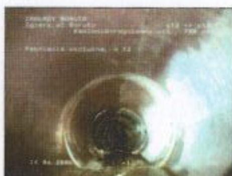
Nr sekcji: 10, Zdjęcie: 77a, Nr taśmy: , 00:00:00, Pęknięcie wzdłużne, o 12
