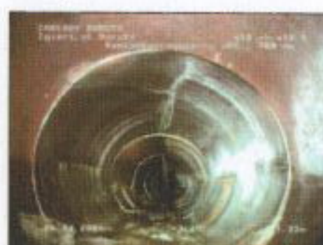
Nr sekcji: 10, Zdjęcie: 78a, Nr taśmy: , 00:00:00, Wiele pęknięć, z 09 do 03
