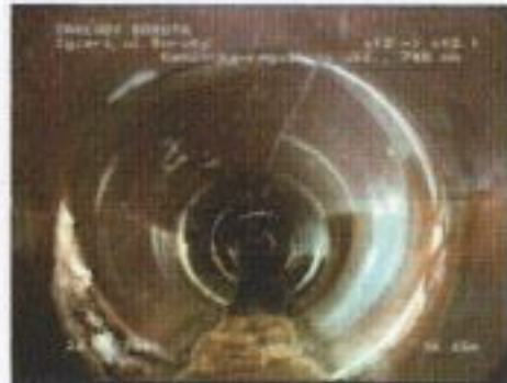
Nr sekcji: 10, Zdjęcie: 89a, Nr taśmy: , 00:00:00, Pęknięcie wzdłużne, z 09 do 03
