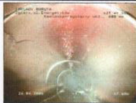
Nr sekcji: 3, Zdjęcie: 28a, Nr taśmy: , 00:00:00, Wiele pęknięć, z 10 do 02
