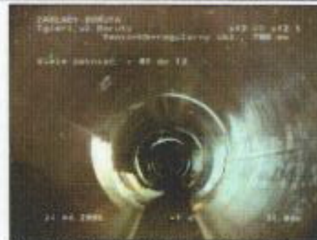
Nr sekcji: 10, Zdjęcie: 86a, Nr taśmy: , 00:00:00, Wiele pęknięć, z 09 do 12
