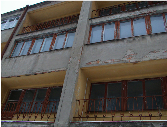
Fot.5 Ubytki tynku zewnętrznego
