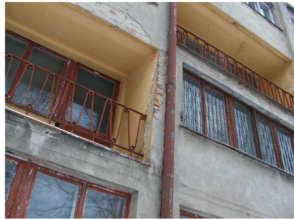
Fot.6 Ubytki tynku zewnętrznego c.d.
