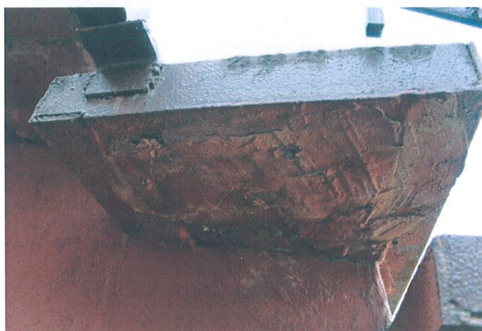
Fot. 2 Widok zniszczonej powłoki stopnic od spodu
