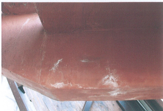
Fot. 3 Widok belek polickowych z widocznymi wykwitami
