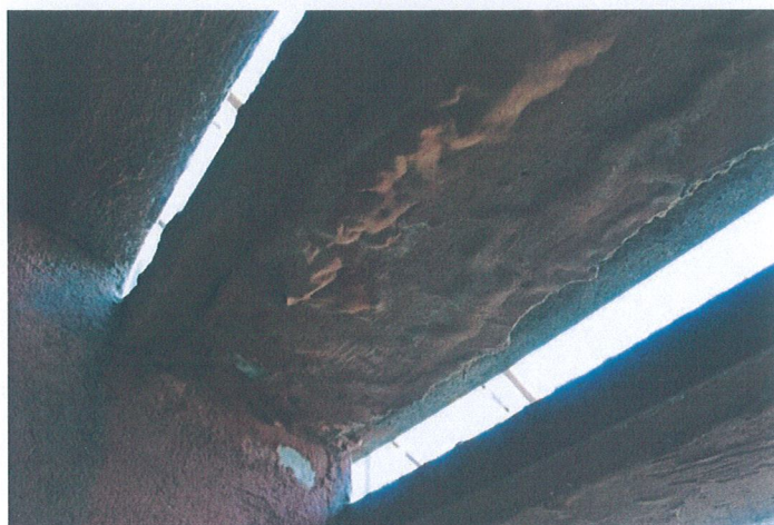
Fot. 4 Widok belek polickowych z widocznymi wykwitami
