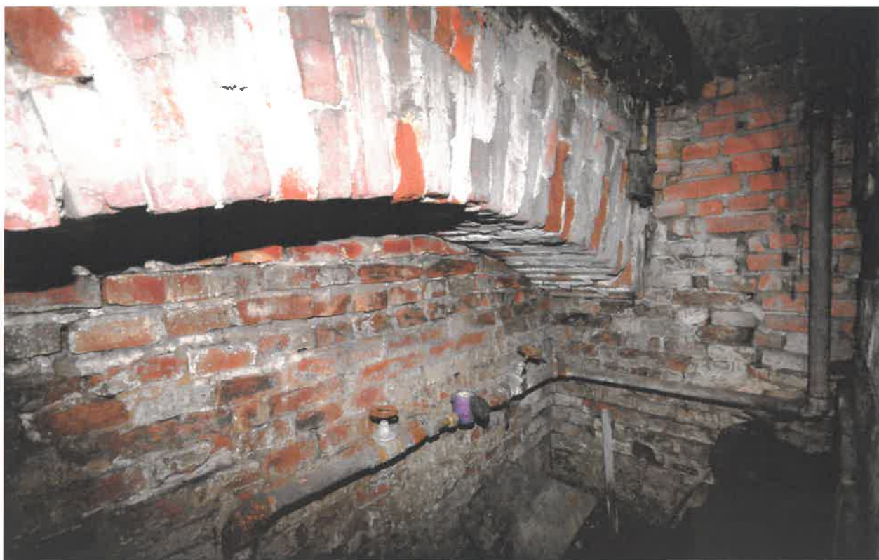
Zdj. nr 18. Stan ścian podpiwniczenia.
