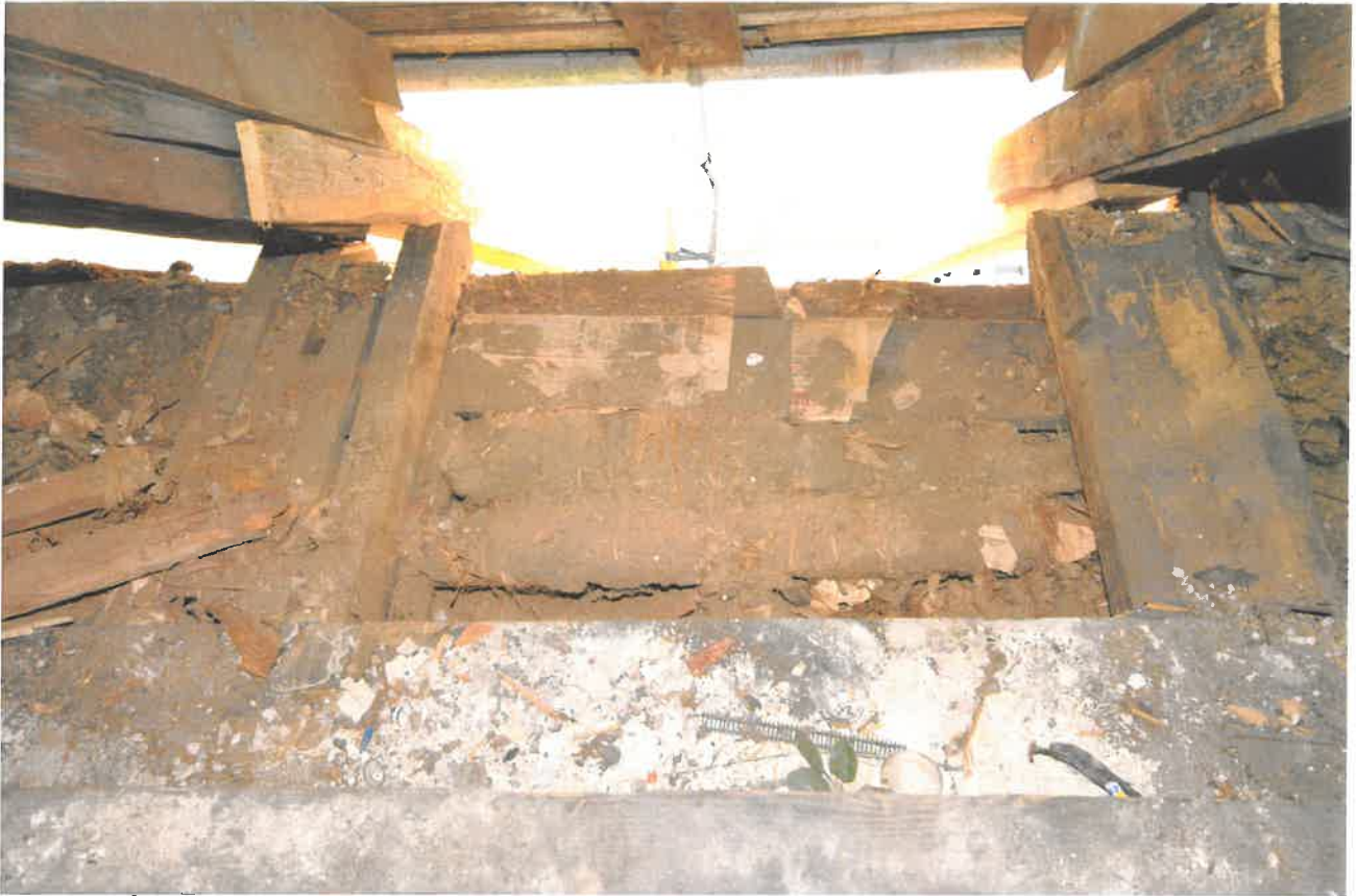
Zdj. nr 5. Ślepa podłoga na wsuwkę + zerwane połączenie belek stropu z krokwiemi i wzmocnienie nakładkami stropu.
