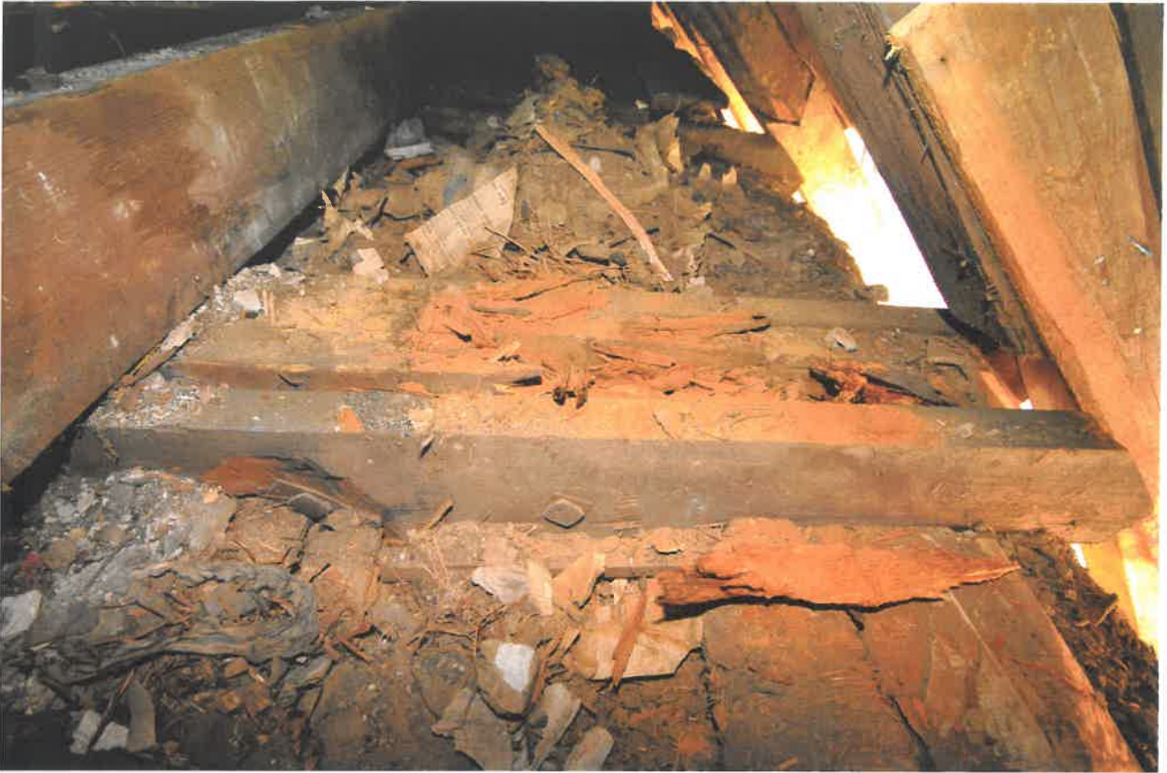
Zdj. nr 11. Stan belek stropowych i wykonane wzmocnienia.
