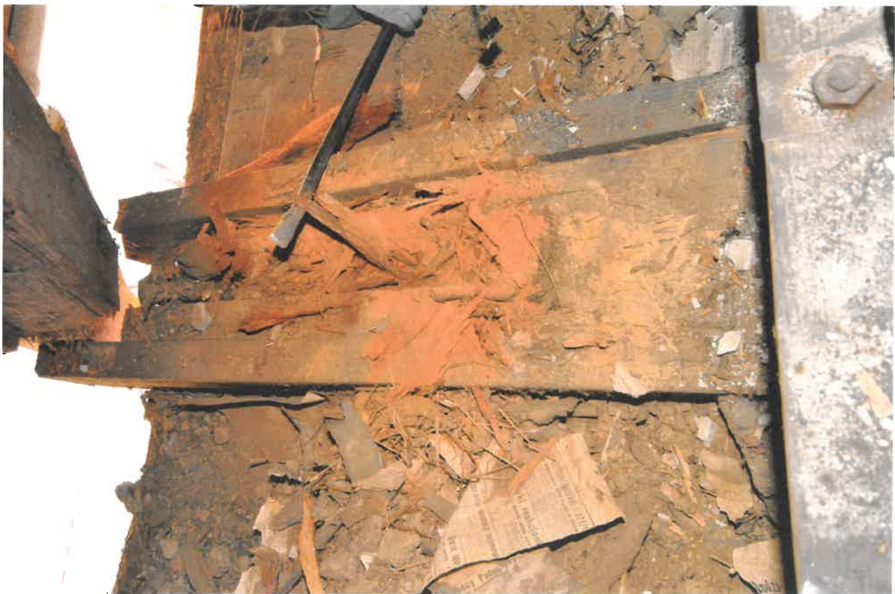
Zdj. nr 10. Stan belek stropowych i wykonane wzmocnienia.
