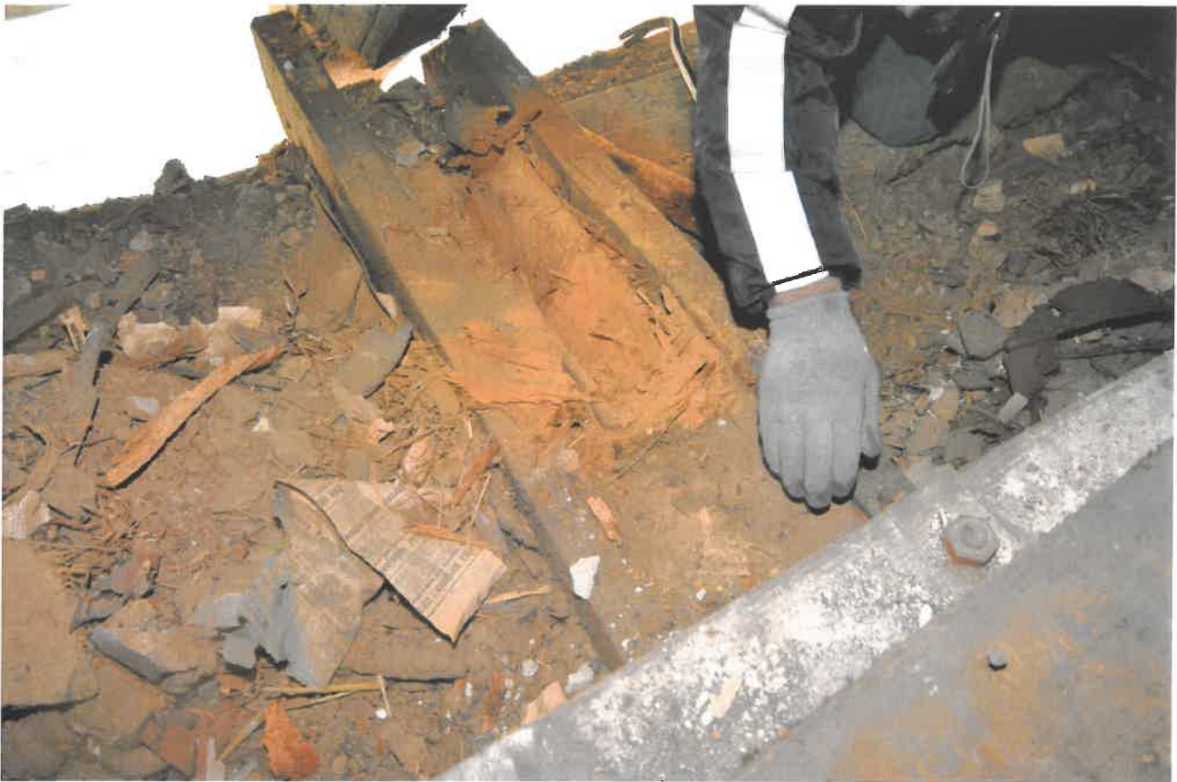
Zdj. nr 9. Stan belek stropowych i wykonane wzmocnienia.
