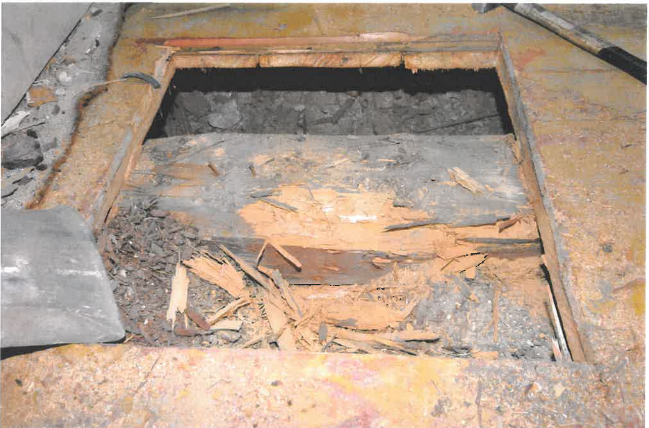
Zdj. nr 8. Stan belek stropowych.
