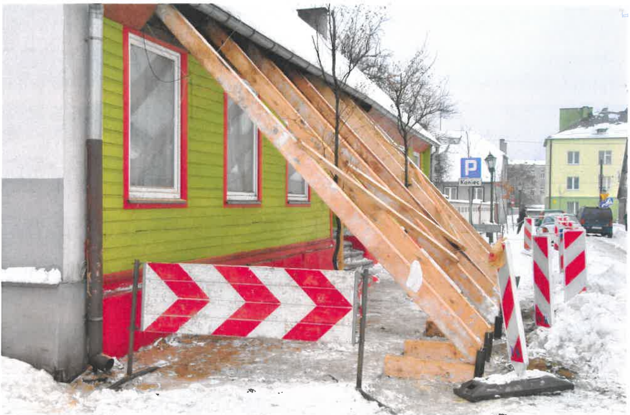
Zdj. nr 2. Widok części dachu uniesionej w trakcie wybuchu.
