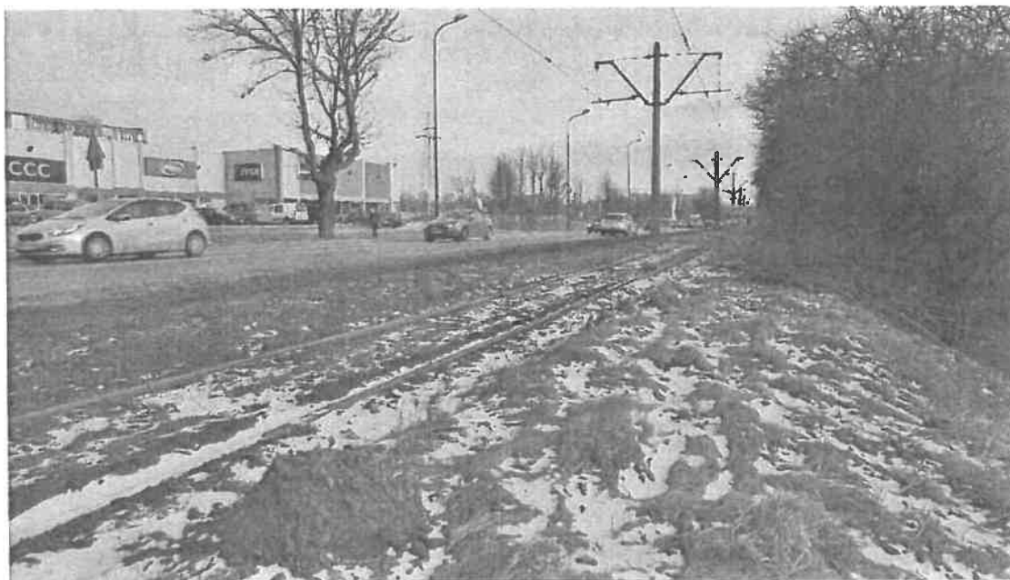
Fot. 13. Kretowiny na krawędzi torowiska w pobliżu południowej krawędzi osiedla Kurak
